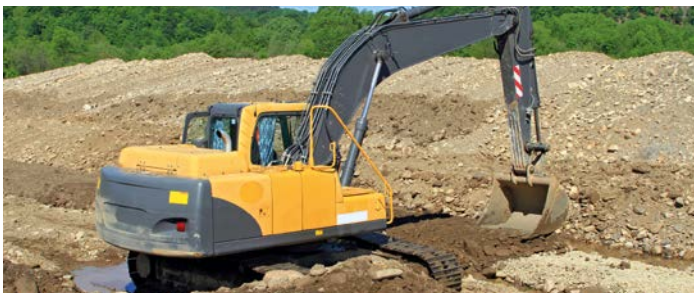
Neigungsmessung an Schaufel, Ausleger und Fahrwerk für eine optimale Steuerung
